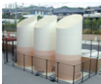
15m 3 デザインタンク×2基+ポンプ室
