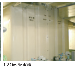
120 m 受水槽 (屋内設置事例)
