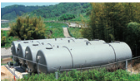
100 m 受水槽×4基
