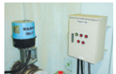
▲緊急遮断弁と制御盤
