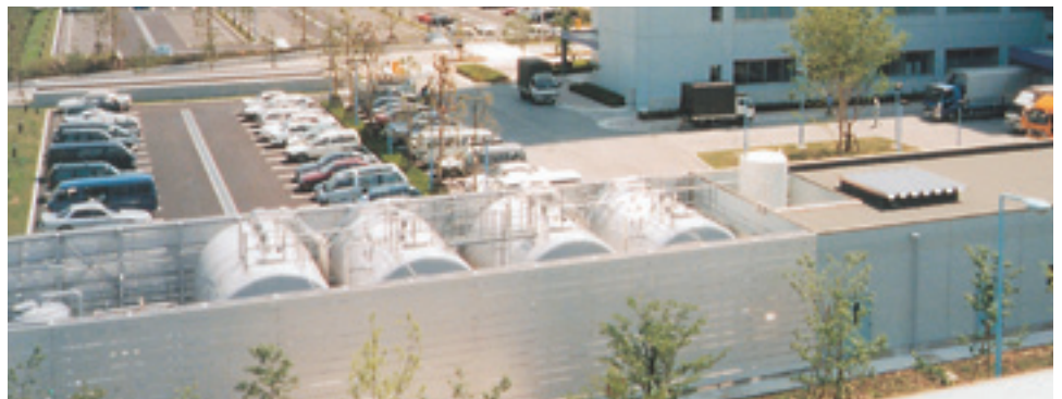
60m 3 ×4基=240m 3 受水槽
